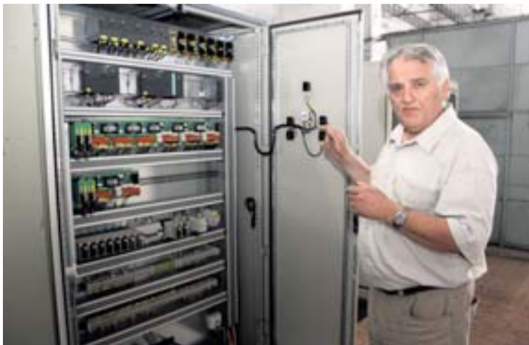
Elektromistr povrchových provozů závodu 2 Dolu Darkov Janis Pantadis ukazuje „střeva“ jednoho ze dvou automatů Simatic ve strojovně těžních zařízení, které jsou mozgovými centry nového systému řízení a kontroly návěsního zařízení jámy Mír 5.
