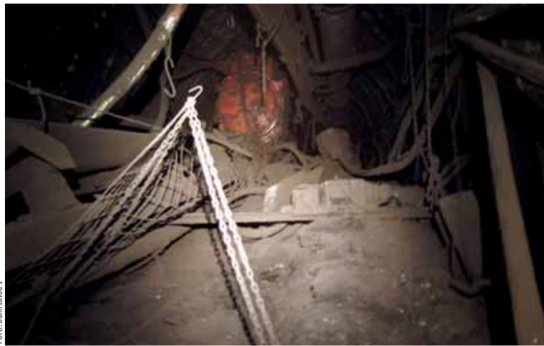
Ražba chodby 22 4003 byla po otřesu zastavena.
