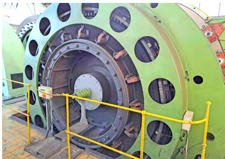
Motor těžního zařízení ve skipové věži.
